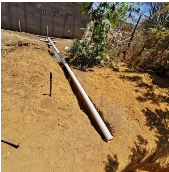
Figura 3. Tubulação em vala até a área de implantação dos Círculos de Bananeiras.
