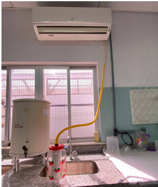
Figura 2. Conexão do dreno do aparelho de ar-condicionado ao sistema de purificação alternativo.
