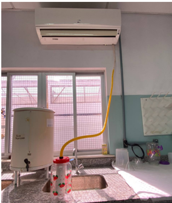
Figura 2. Conexão do dreno do aparelho de ar-condicionado ao sistema de purificação alternativo.
