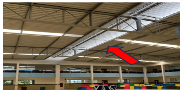
Figura 5. Sistema de ventilação natural por lanternim na área de convivência (vista interna).
