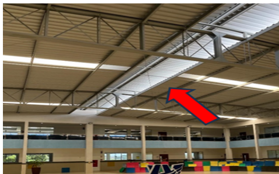
Figura 5 – Sistema de ventilação natural por lanternim na área de convivência (vista interna).
