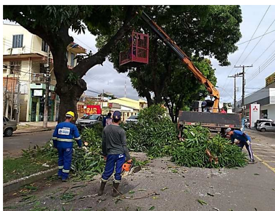
Figura 2 - Poda para evitar acidentes com fiação elétrica e quedas de árvores na Praça São Sebastião.
